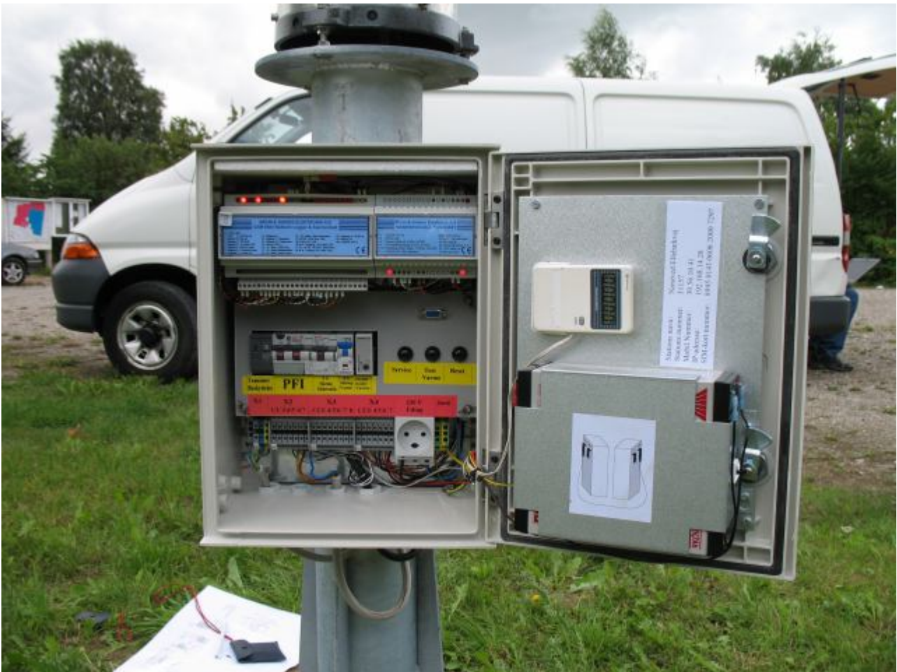
Figur 7: Nedbørmålerinstallation med det nye styreskab opstillet på Ellebækvej i Næstved. (Stations nr. 31157)
