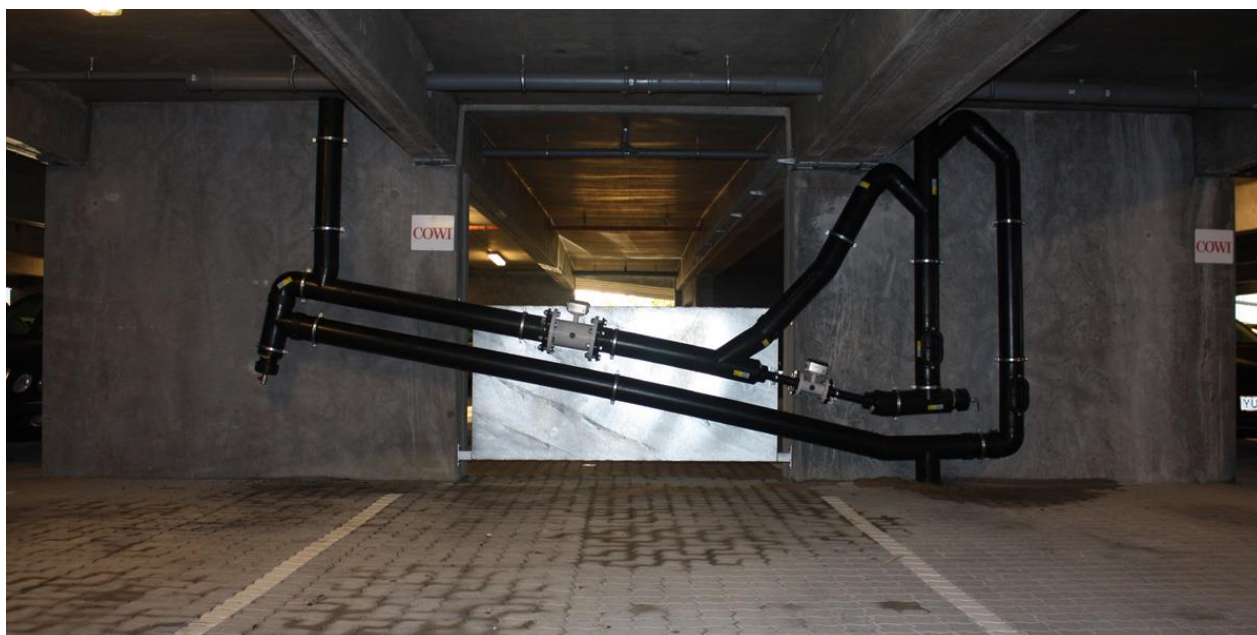
Figur 8.2: Flowmålersystem uden isolering og varmekabler.
